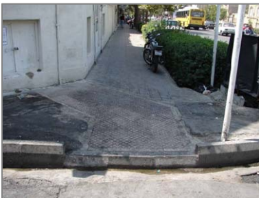
شکل هشت: اتصال نادرست پیاده‌رو به سواره‌رو خیابان دردشت
