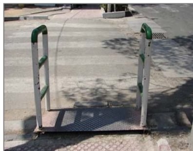
شکل نه: نصب نادرست پل ارتباطی پیاده‌رو- سواره‌رو، خیابان دردشت
